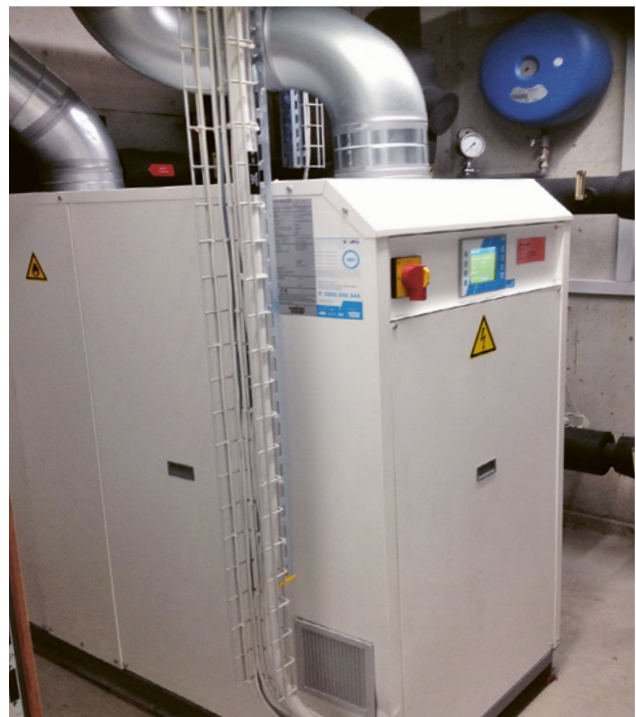
Kälteanlage in belüftetem Gehäuse.
