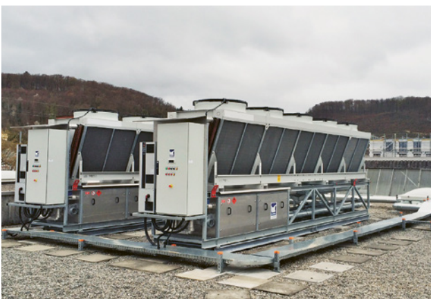
Kälteanlage im Freien.
